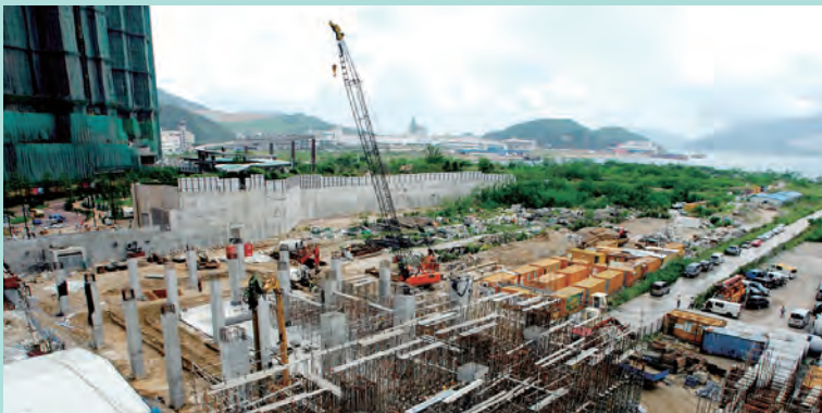
將軍澳市地段第70號86區E地盤住宅項目之 道路及主要設施工程合約
