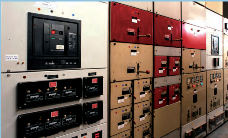
樂富中心乾貨市場的機電工程
